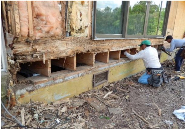
흰 개미 피해를 입은 Deck 과 거실쪽 벽면 공사 I (5 월 12 일)
